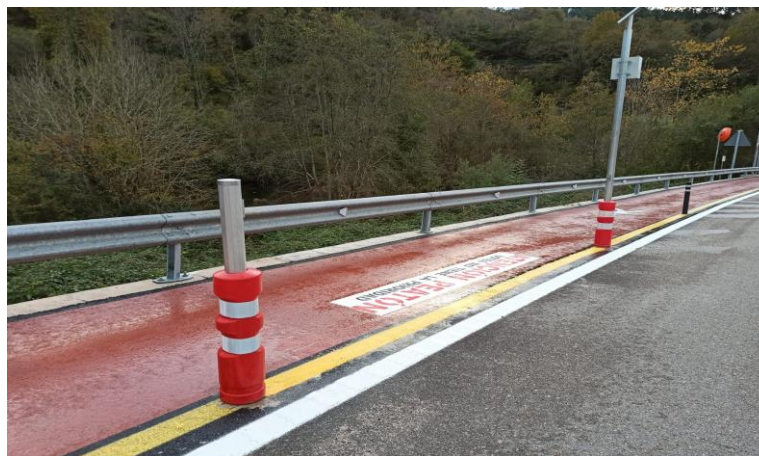
SEÑALIZACIÓN HORIZONTAL ENCAUZAMIENTO PEATONES
