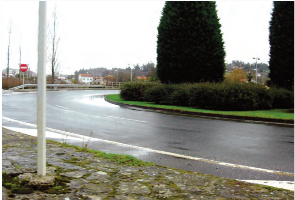
Fotografía 2.- Acumulación de agua en la calzada en el anillo circular. (Fuente: Autores de las recomendaciones)
