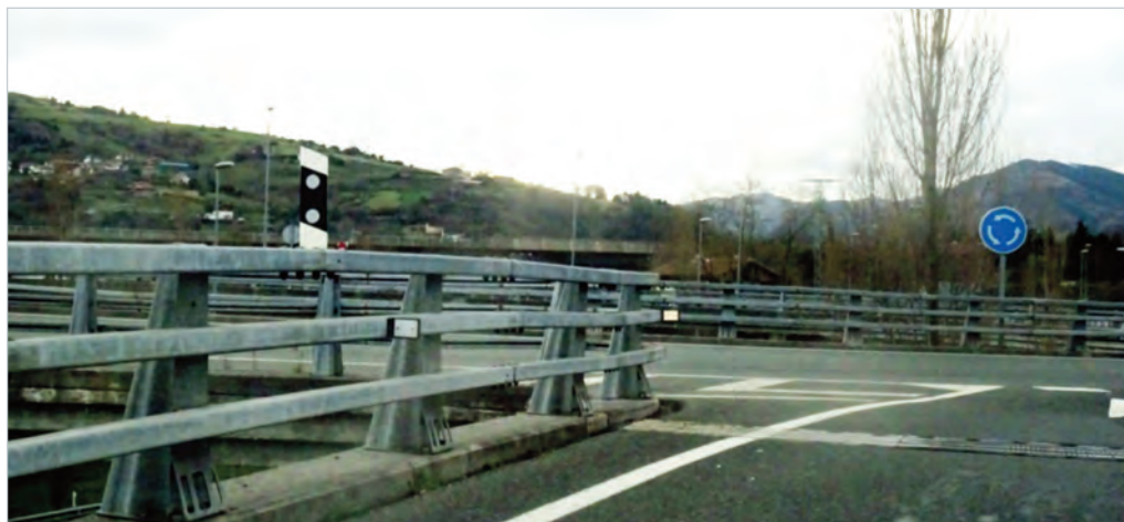
Fotografía 1.- El equipamiento no debería restringir la visibilidad en los accesos. (Fuente: Autores de las recomendaciones)
