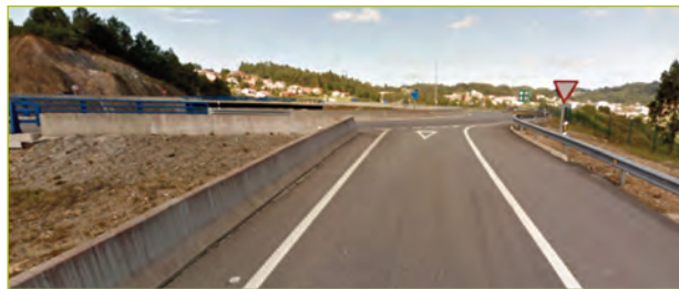
Fotografía 30.- Visibilidad restringida por pretil. (Fuente: Autores de las recomendaciones)
