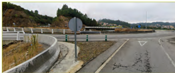
Fotografía 31.- Modificación de pretil para mejorar la visibilidad. (Fuente: Autores de las recomendaciones)
