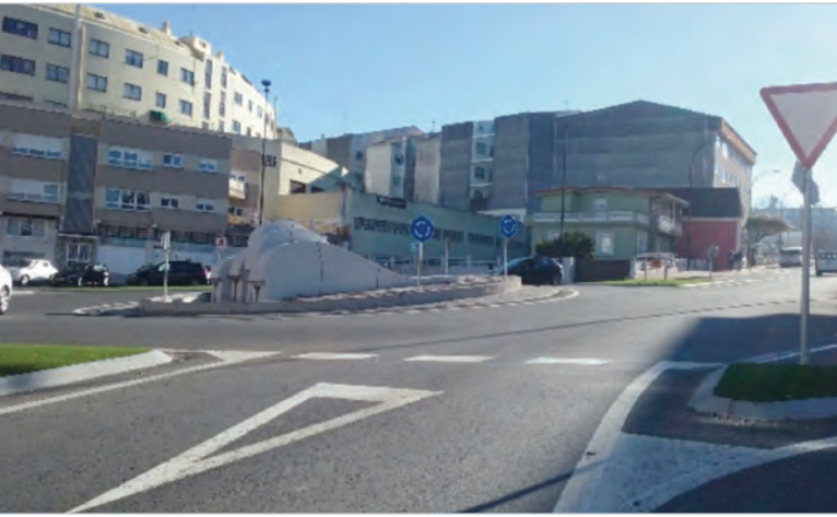
Fotografía 3.- Pendiente mal ejecutada en glorietas. (Fuente: Autores de las recomendaciones)
