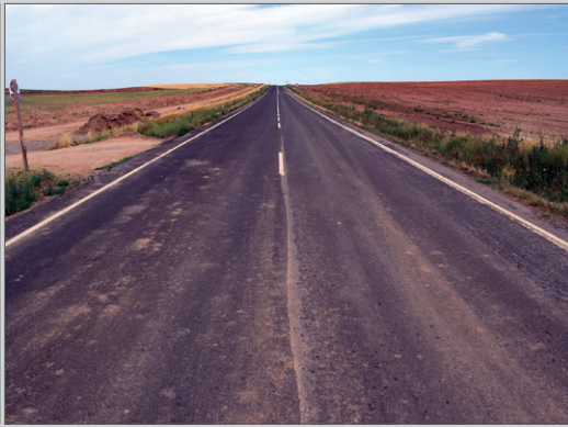
Es necesario repintar las marcas viales en 20.000 kilómetros de carreteras.
