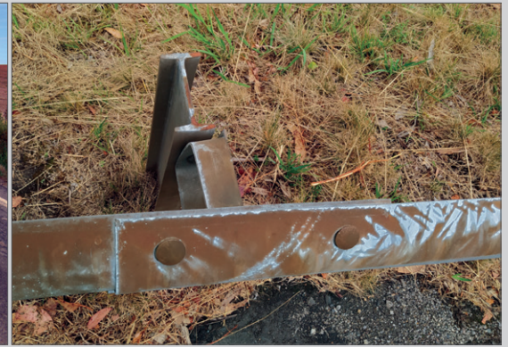
Las barreras metálicas siguen mal, pero no peor. Necesitan 320 millones de euros de inversión para su mejora.
